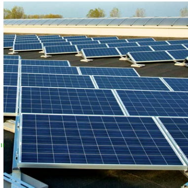
Zonnepark van 1.650 kWp
