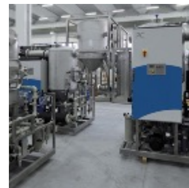
Eigen waterzuiverings- installatie
